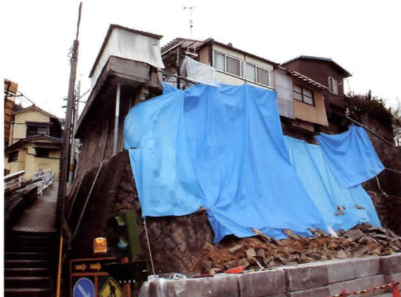
写真1 擁壁の被害（呉市宮原8丁目）
