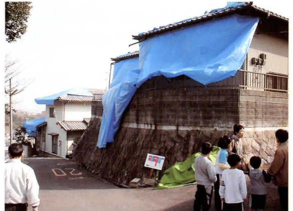
写真4 住宅の瓦屋根被害（西区己斐上3丁目）
