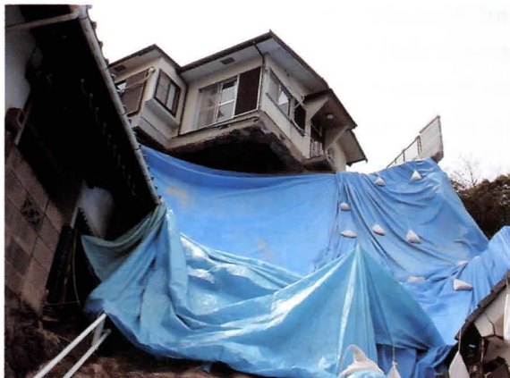
写真2 急傾斜地盤の崩壊による建物被害 （呉市両城2丁目）
