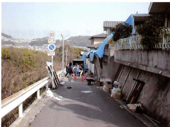
写真3 住宅の擁壁の倒壊。道路左側は急な傾斜地で路面が下がっている（西区己斐上3丁目）
