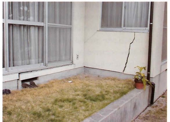
写真5 地盤液状化によって亀裂の入った平屋住宅の布基礎と壁。屋根は無被害（廿日市市阿品）
