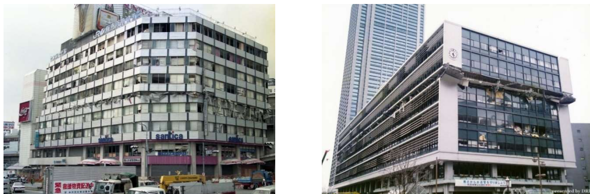
写真 1.1-2 中間層の破壊した非充腹型 SRC 造建物
