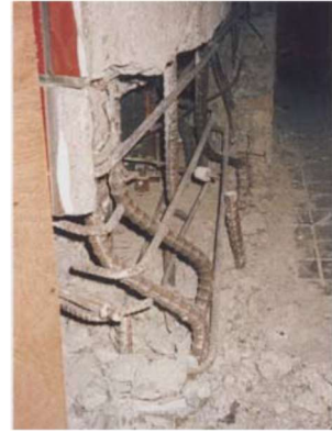
(b) 非埋め込み式柱脚の破壊
