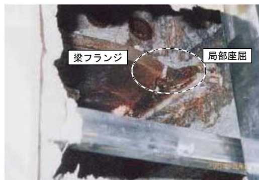
写真 1.2 梁フランジ局部座屈
