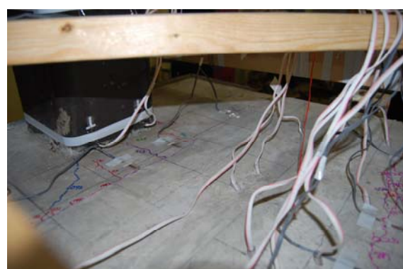
写真 22 実験後のスラブひび割れ 4(梁端部近傍)
